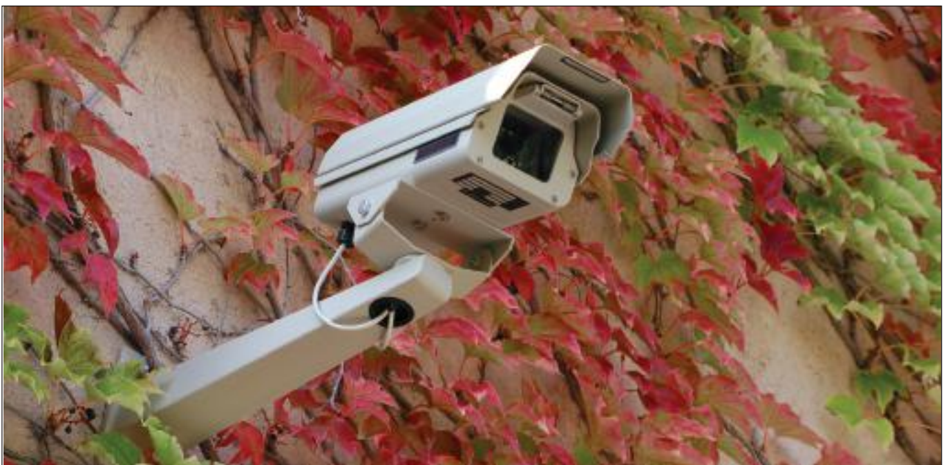
Neufs caméras seront installées
